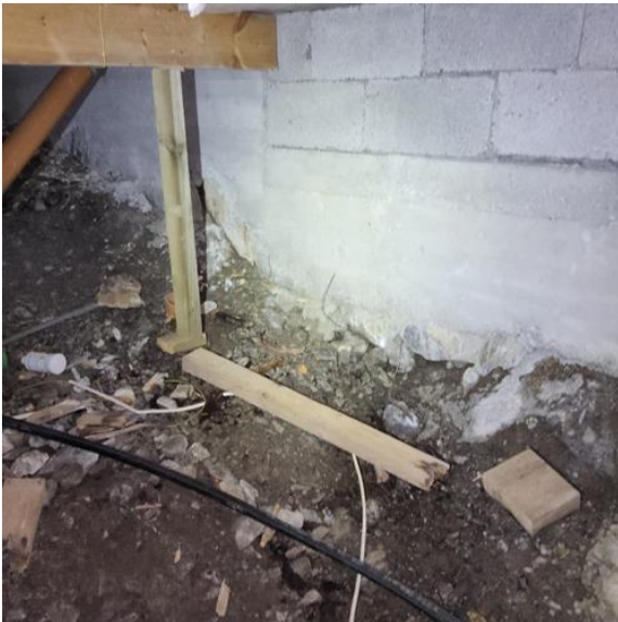
Innvendig - [Eksempel på provisoriske understøttelser og tilsig av fukt i grunnen i krypkjeller]
