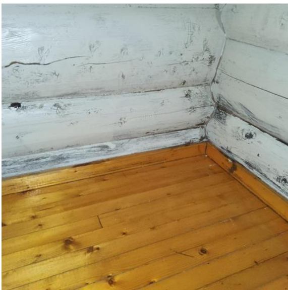
Innvendig - [Eksempel på misfarging på tømmer]
