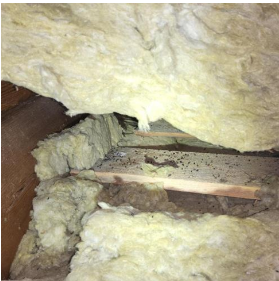
Innvendig - [Eksempel på spor etter skadedyr på loft]
