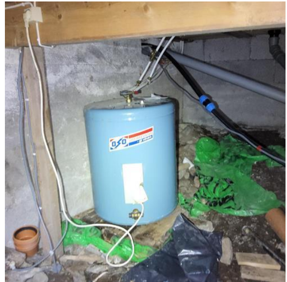
Innvendig - [Varmtvannsbereder i krypkjeller]
