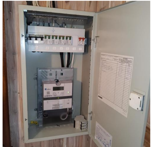
Elektrisk anlegg - [Sikringskap og kursoversikt]
