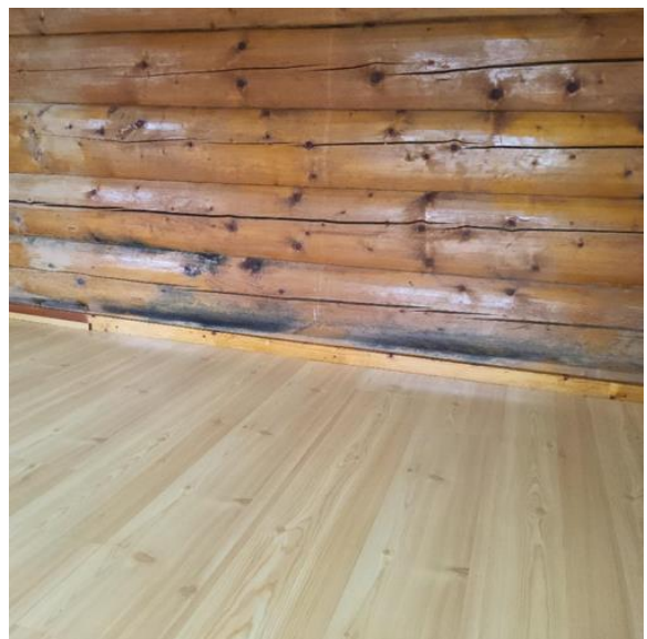
Innvendig - [Eksempel på misfarging på tømmer]
