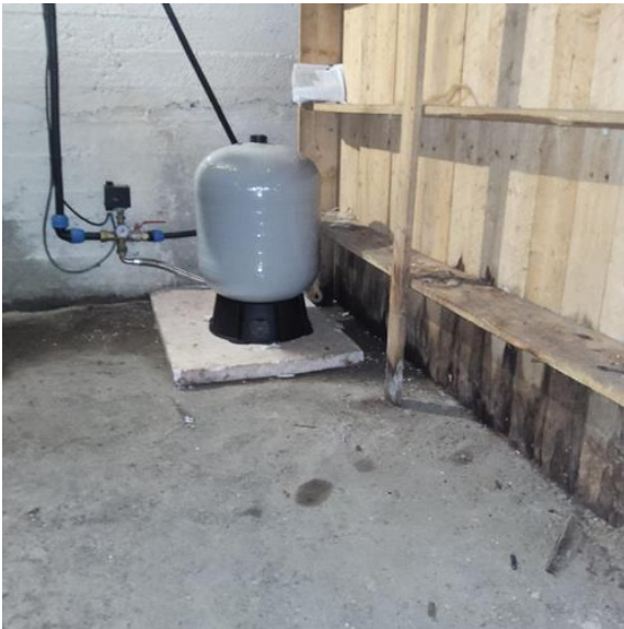
Innvendig - [Hovedstoppekran, trykktank og råteskader i kjeller]
