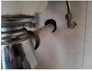
Vanntett sjikt / membran i gulv og vegger - Utette rørgjennomføringer i vegg under servant.
