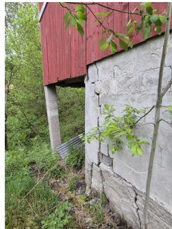
Fundament, grunnmur og gulv mot grunn - Eksempel på sprekker i grunnmur og skjevhet i søylefundament.
