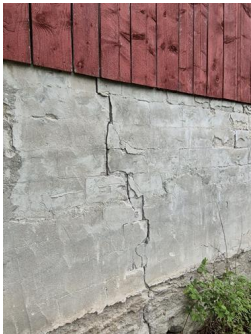
Fundament, grunnmur og gulv mot grunn - Eksempel på sprekker i grunnmur.
