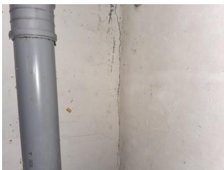
Overflate vegg - Eksempel på sprekker i vegg.
