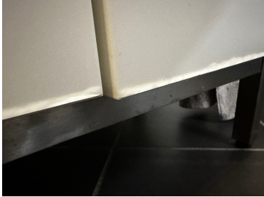
Fukt svelling skapdør
