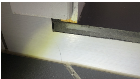
sprekk i flis ved døråpning.
