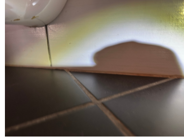
Manglende lekkasjesikring toalett
