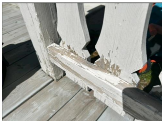
Tilstand på rekkverk og overflatematerialer - -
