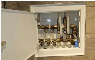
Fordelerskap og fordelerstammer - Fordelerskap.
