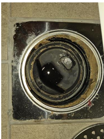
Avløpsrør (ink. sluk) - [Sluk, bad]
