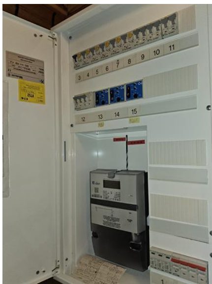
Elektrisk anlegg - [Sikringsskap]
