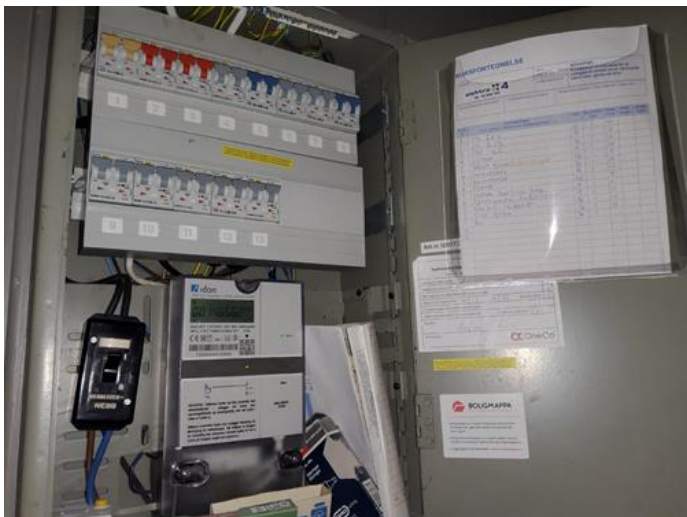
Elektrisk anlegg - [Sikringsskap]
