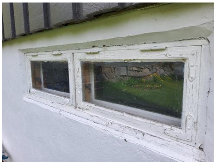
Beskrivelse - [Slitasje på kjellervinduer]
