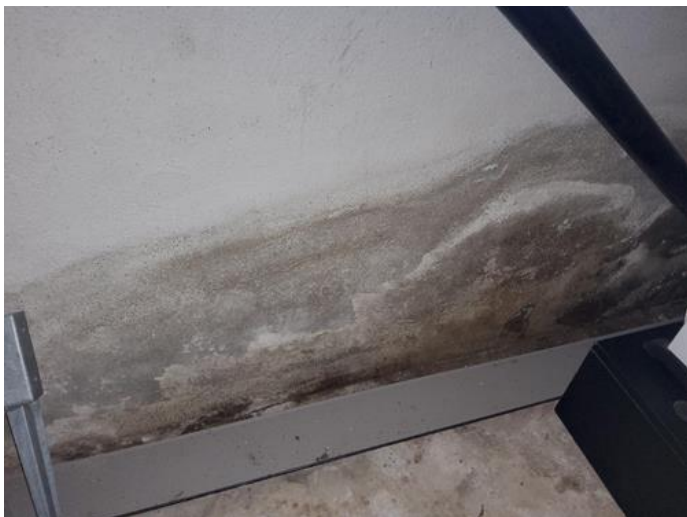
Kommentar - [Eksempel på fukt i kjeller]
