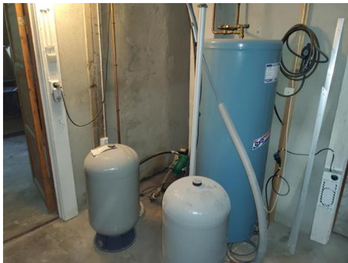
Beskrivelse - [Teknisk anlegg]
