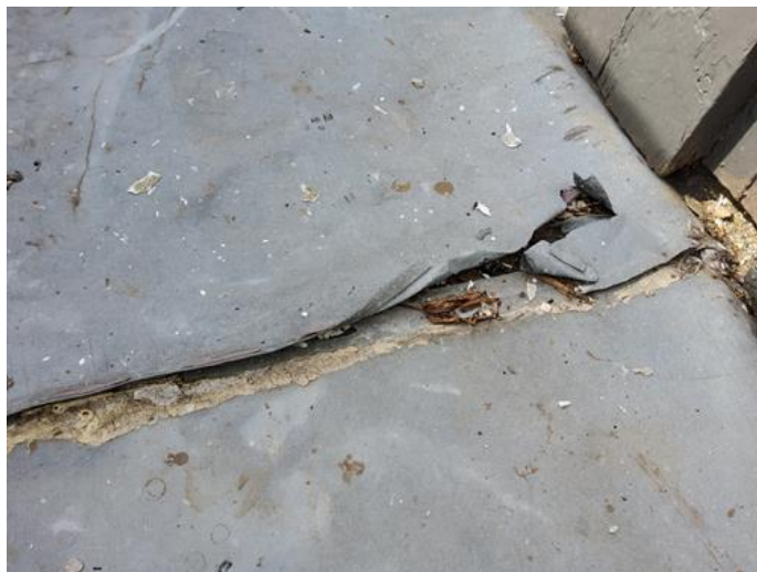
Kommentar - [Utettheter/skader i beslag på balkong]
