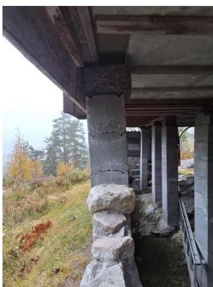
Utvendig - [Skjeve fundamenter]
