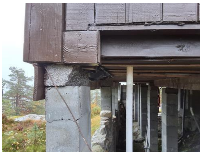
Utvendig - [Fundamenter, med noe skjevheter]
