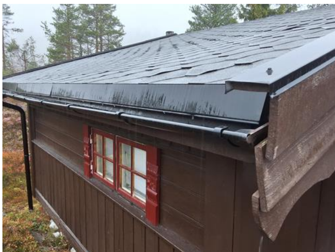
Utvendig - [Deformasjon av takrenne]
