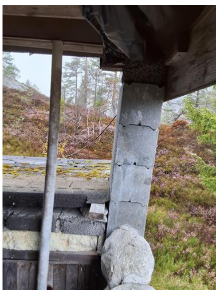
Utvendig - [Skjeve fundamenter]
