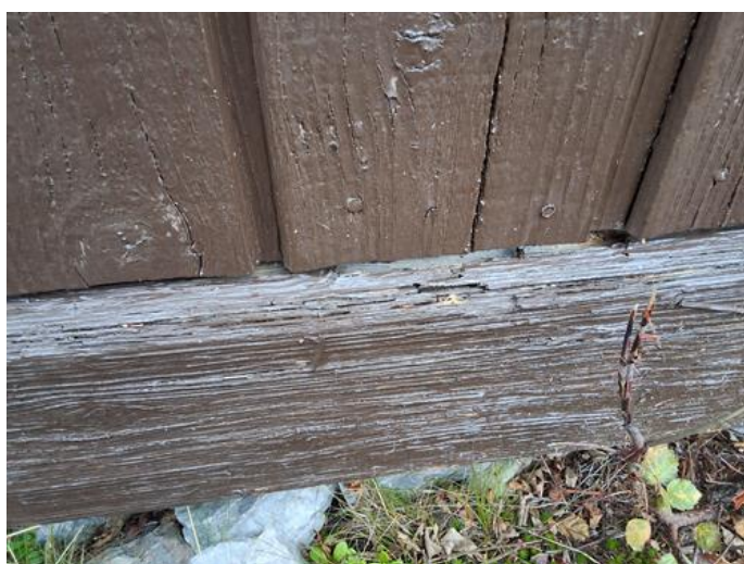
Utvendig - [Råtedannelse i bunnbord]
