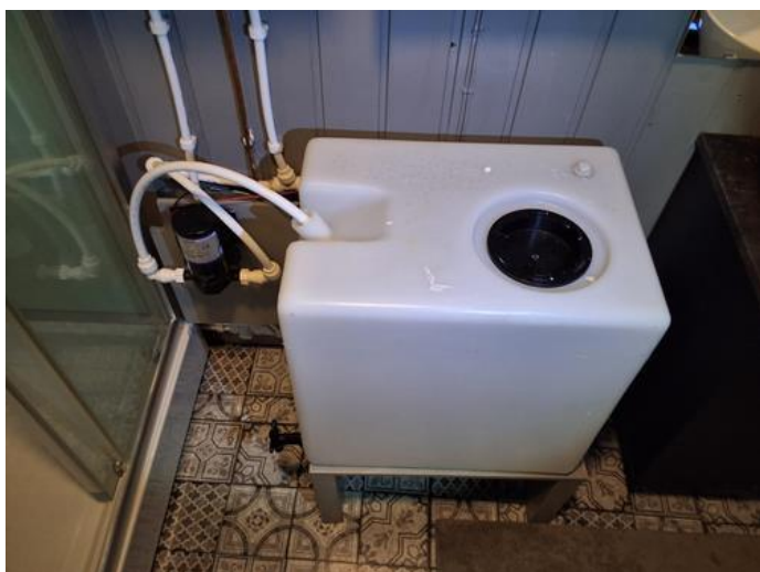
Innvendig - [Vanntank på badet]
