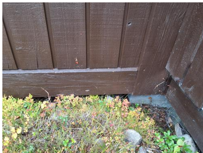
Utvendig - [Liten klaring til terreng mot sørvest]
