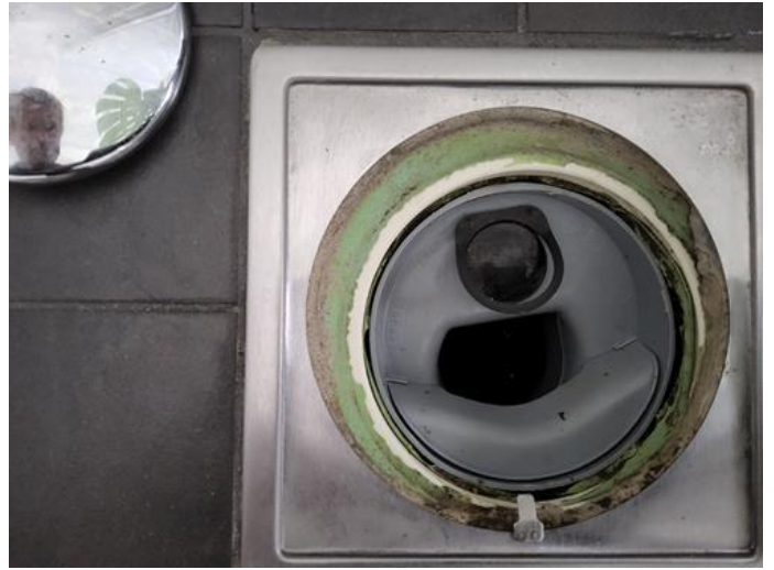
Avløpsrør (ink. sluk) - [Sluk i dusj på bad 1.]
