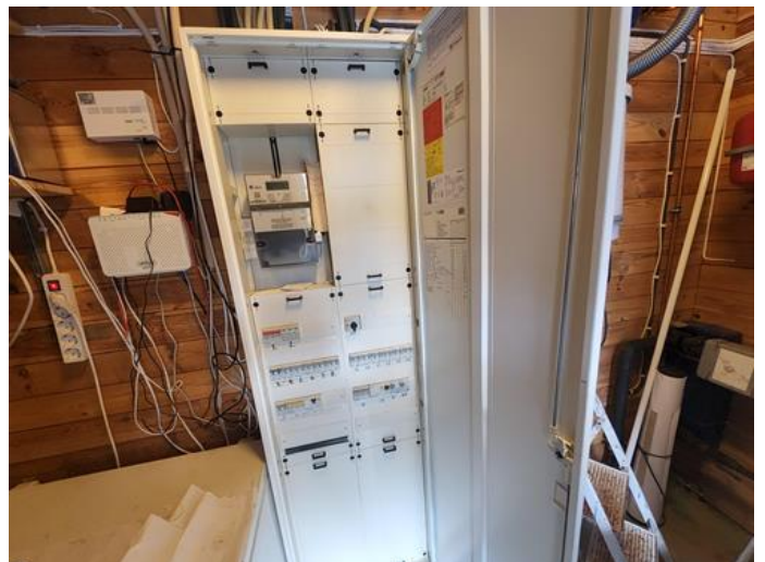
Elektrisk anlegg - [Sikringsskap.]
