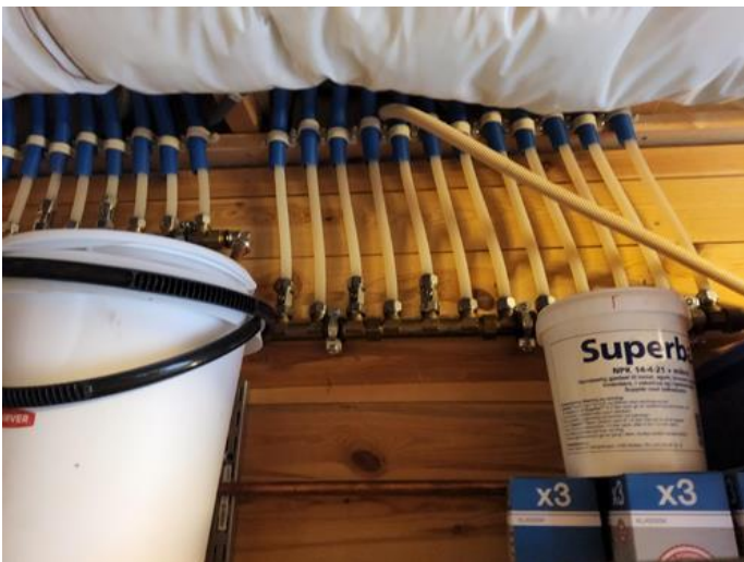
Vannrør (Sjekkpunkter utover det som er inkludert i andre rom) - [Fordelerstammer for rør-i-rør.]
