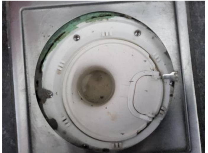
Avløpsrør (ink. sluk) - [Sluk på vaskerom.]
