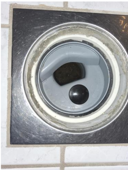
Avløpsrør (ink. sluk) - [Sluk utenfor dusjsonen på bad i underetasje. ]
