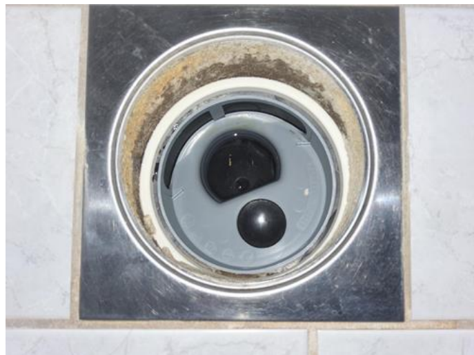
Avløpsrør (ink. sluk) - [Sluk i dusjsonen på bad unnderetasje. ]
