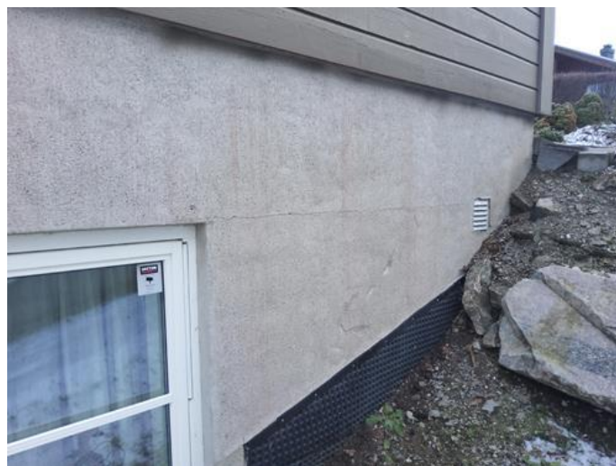
Grunnmur - [Riss/sprekker i grunnmur. ]
