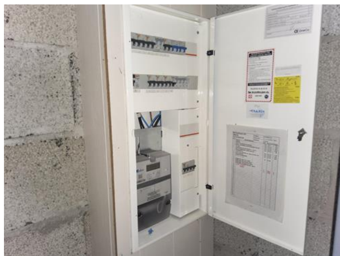
Elektrisk anlegg - [Sikringsskap. ]
