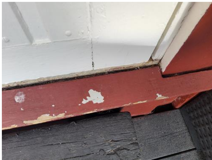
Dører - [Manglende beslag ved verandadør]
