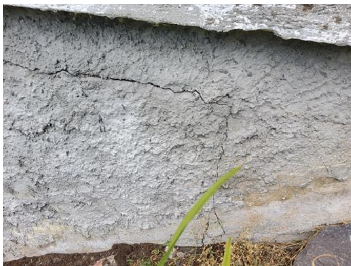
Grunnmur - [Sprekker på grunnmur]
