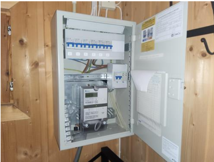
Elektrisk anlegg - [Sikringskapp.]
