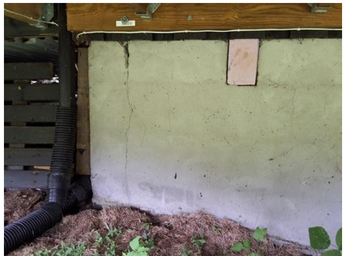
Grunnmur, fundamenter - [Grunnmur, riss/sprekk i lettklinkerblokker under tilbygg]
