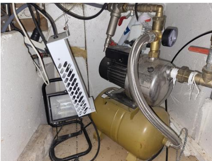
Tekniske anlegg, VVS anlegg (Sjekkpunkter utover det som er inkludert i andre rom) - [Vannpumpe og trykktank]
