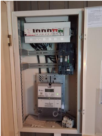
Elektrisk anlegg - [Sikringskap på soverom]
