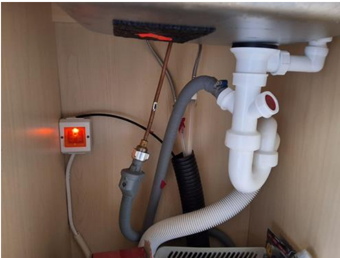
Kjøkkenen - [Røropplegg i kjøkkenbenk]
