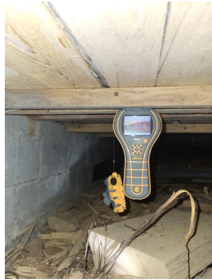
Krypekjeller - [Fuktmålinger i treverket over 20 %]
