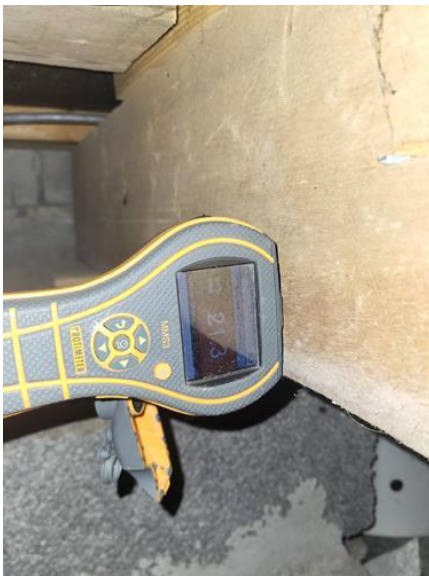
Krypekjeller - [Fuktmålinger i treverket over 20 %]
