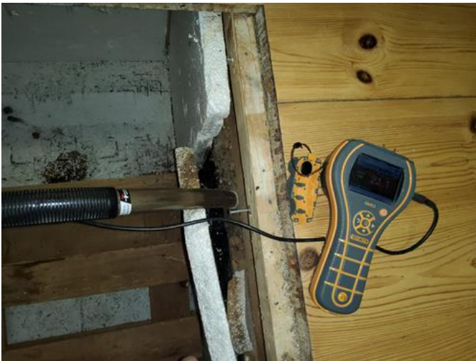
Kommentar - [Fukmåling i bjelkelag ved luke på kjøkken]
