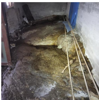
Helhetsvurdering - Eksempel på fuktproblematikk i krypkjeller
