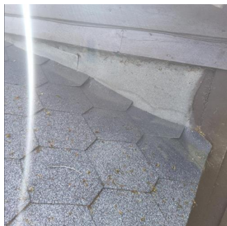
Detaljer inn mot tilstøtende konstruksjoner - Eksempel på ufagmessig utførelse over inngangsparti
