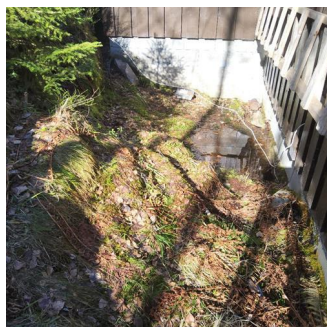
Helhetsvurdering - Eksempel på terrengfall og vann mot bolig
