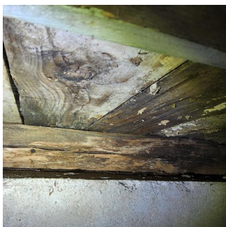
Helhetsvurdering - Eksempel på råteskader i indre del av krypekjelleren
