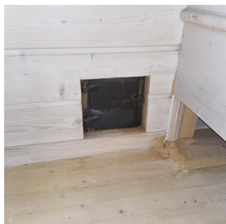
Skorsteiner inne i boligen - Sotluke for nært brennbart
