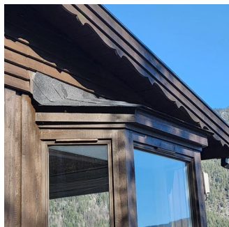
Detaljer inn mot tilstøtende konstruksjoner - Eksempel på ufagmessig utførelse over karnapp
