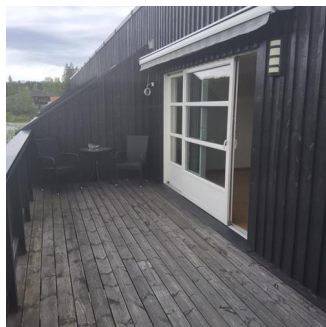
Tilstand på rekkverk og overflatematerialer - Balkong med markise
