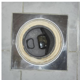
Avløp (inkl. sluk) - Sluk i dusjsonen
