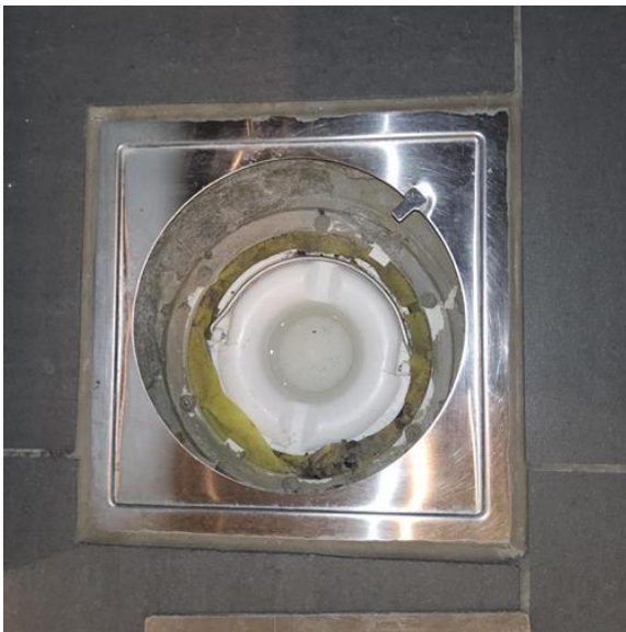
Avløpsrør (ink. sluk) - [Sluk bad 1.etasje ]
