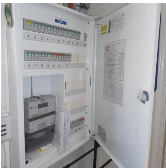
Elektrisk anlegg - [Sikringsskap og kursoversikt ]
