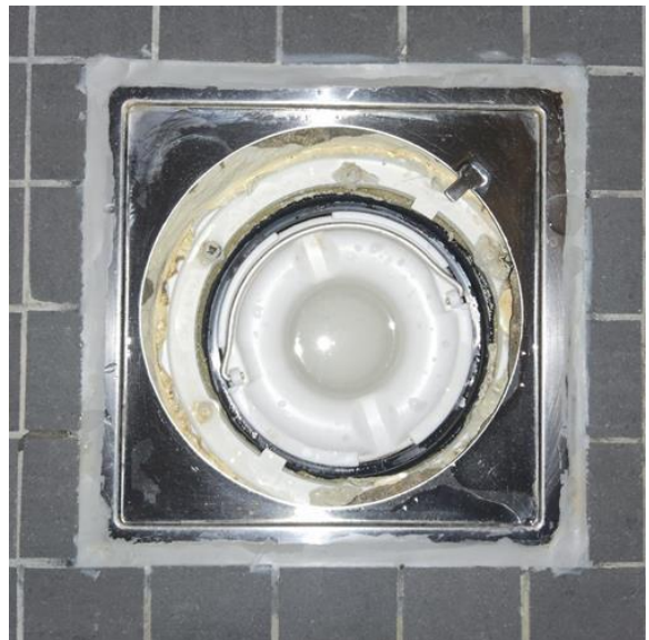
Avløpsrør (ink. sluk) - [Sluk dusjsonen bad 1.etasje ]
