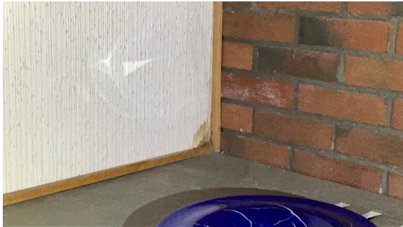
Gammel fuktskade, beslått pipe etterpå.
