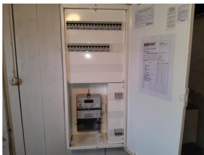
Elektrisk anlegg - [Sikringsskap kjeller. ]
