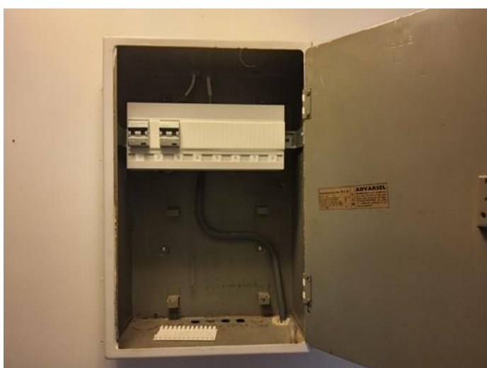
Elektrisk anlegg - [Sikringsskap 2.etasje. ]
