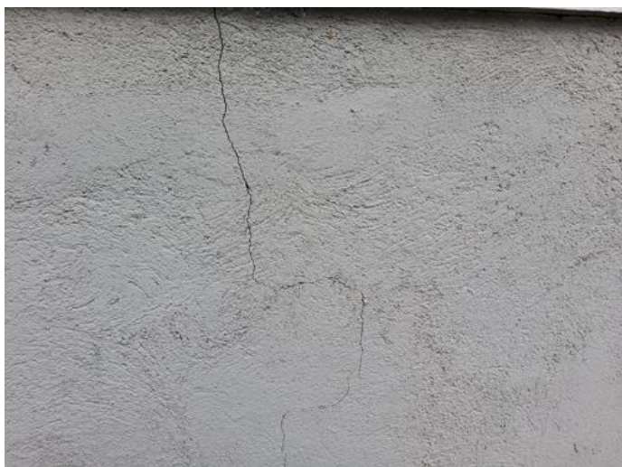
Beskrivelse - [Sprekker i grunnmur]
