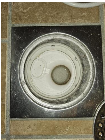
Avløpsrør (ink. sluk) - [Sluk, bad]
