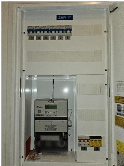
Elektrisk anlegg - [Sikringsskap]
