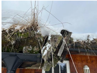
Vannbord, vindskier, gesimskasser og lignende - Skjevheter og råteskader
