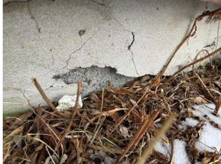
Grunnmur og fundament - Eksempel på avskalling grunnmur
