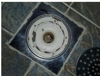
Tettesjiktets tilslutning til sluk - Sluk bad mot vest
