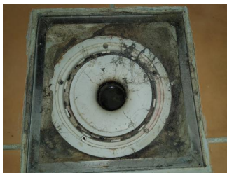
Helhetsvurdering - Sluk bad mot øst
