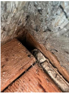
Gnagersikring - Eksempel på mangelfull gnagersikring
