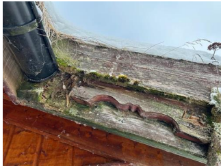
Vannbord, vindskier, gesimskasser og lignende - Eksempel på råteskader
