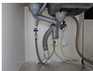
Innredning - Røropplegg i kjøkkenbenk
