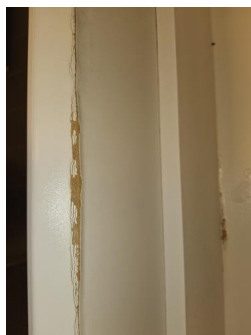
Sanitærutstyr og innredning - Svelling på fronter
