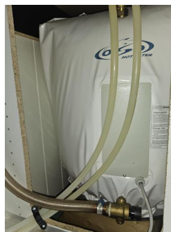
Varmtvannsbereder - VVB i kjøkkenbenk
