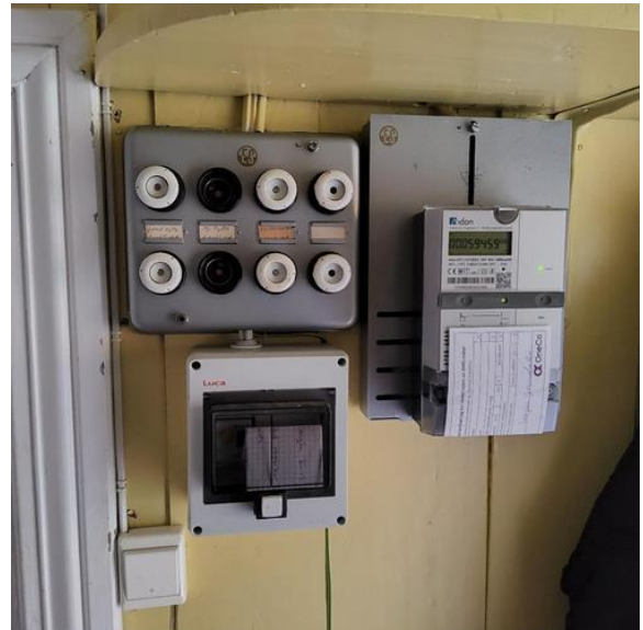
Elektrisk anlegg - [Sikringer plassert i anneks]
