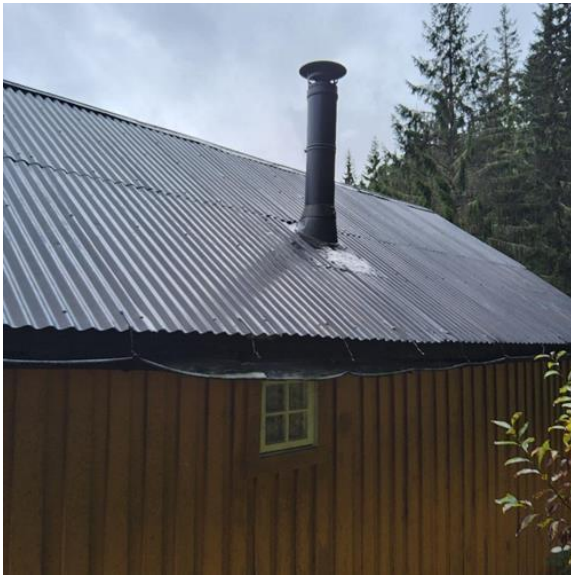
Utvendig - [Eksempel på slitasjer]
