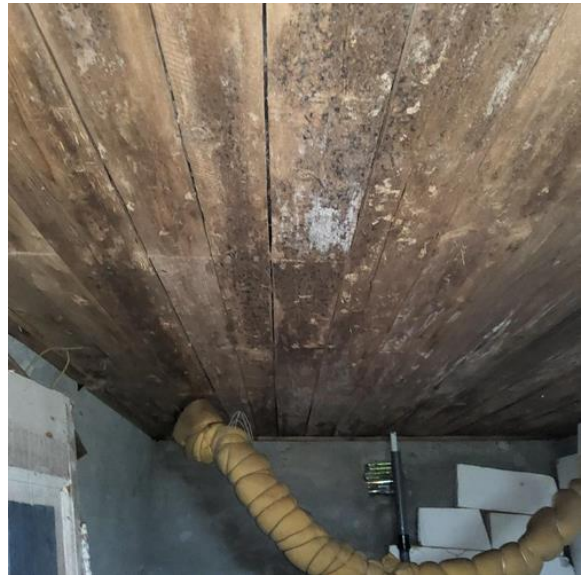
Innvendig - [Eksempel på slitasjer og begynnende råteskader i kjeller]
