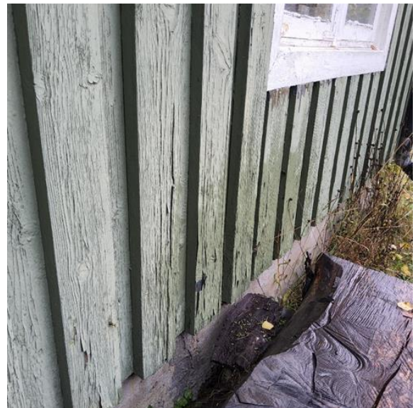
Utvendig - [Eksempel på slitasjer anneks]
