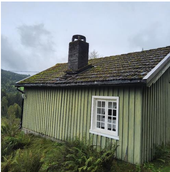
Utvendig - [Eksempel på slitasjer og skader på anneks]
