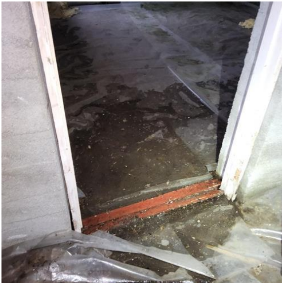
Innvendig - [Eksempel på vann i kjeller]
