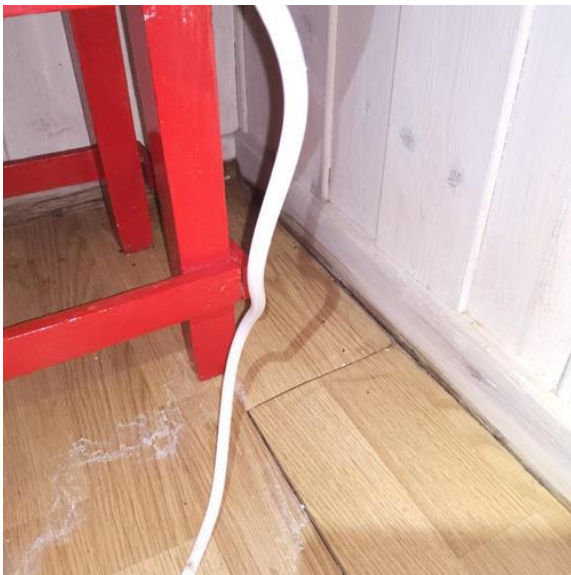
Innvendig - [Eksempel på fuktskader bak dusjkabinett]
