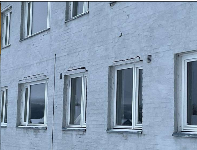
Sprekkdannelse over vinduer.
