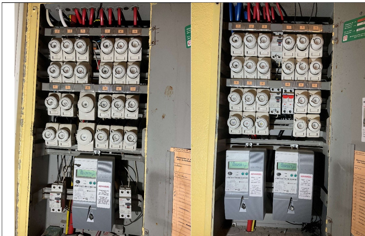
Eksempel fordelingsskap 2.etg.
