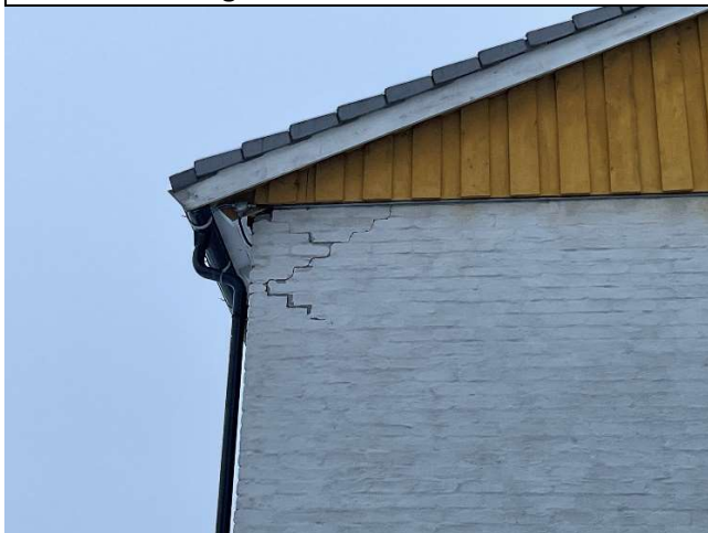
Sprekk i murfasade.
