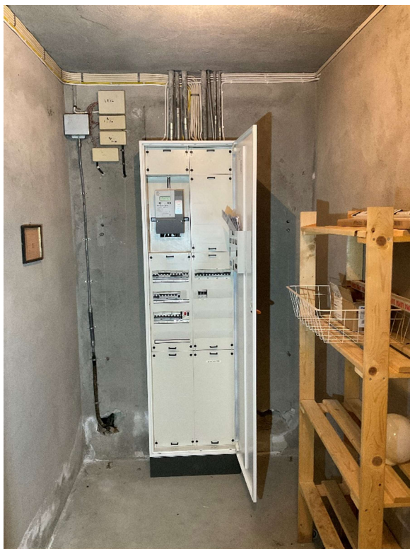
Hovedtavle med måler i underetasjen.
