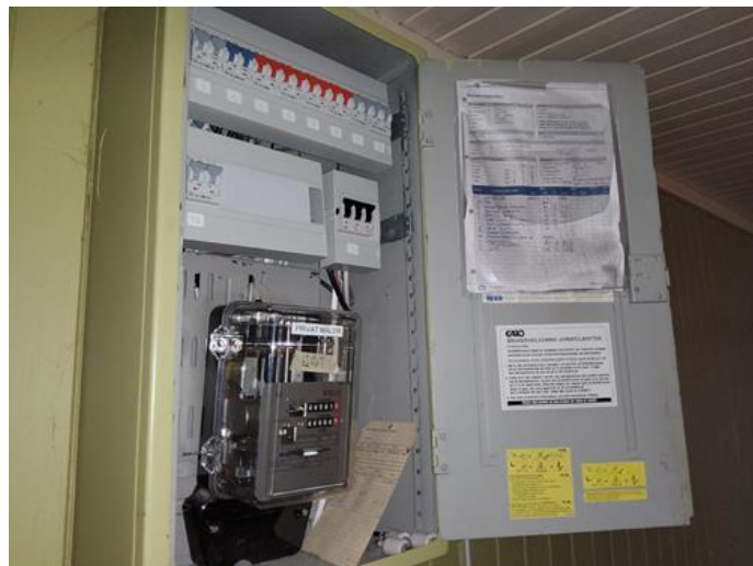
Elektrisk anlegg - [Sikringsskap]
