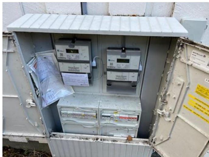
Elektrisk anlegg - [Sikringsskap utvendig]
