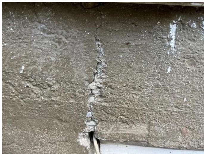
Grunnmur - [Eksempel på sprekker i grunnmur]
