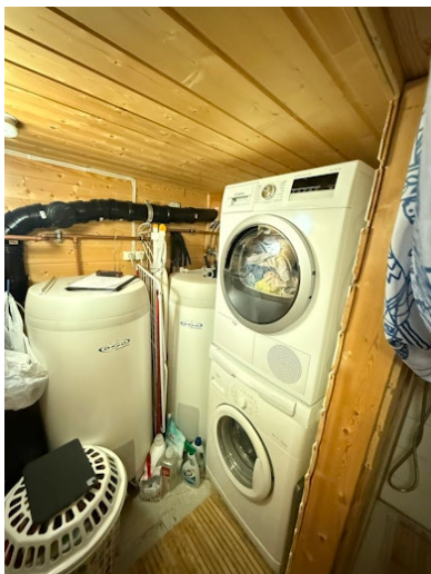
Vaskerom/teknisk rom i kjeller med 2 stk VVB.
