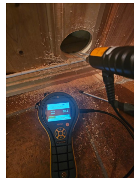
Fuktmåling i svill med tilfredsstillende resultat.
