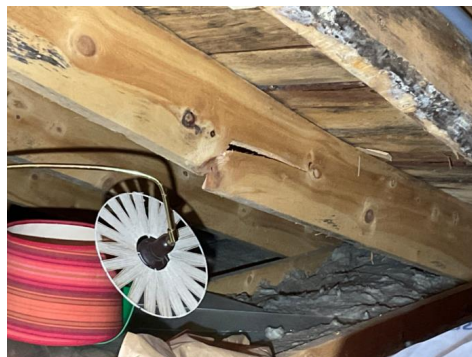
Brudd i taksperrer.
