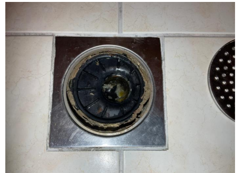
Sluk i høyre rom.
