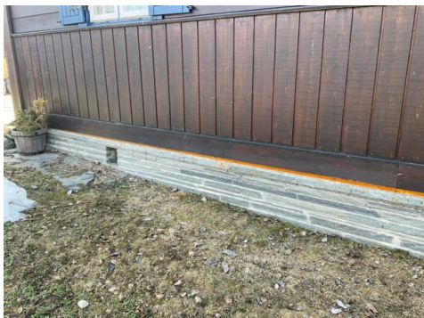
Ingen luftespalte nederst langs muren.
