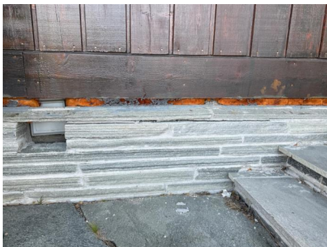
Muren har sunket en del.
