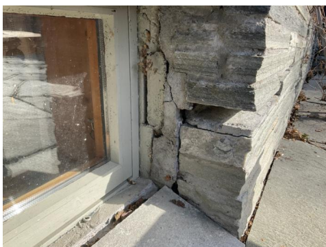
Skade rundt vindu i gavlen.
