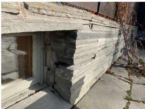
Skade rundt vindu i gavlen.
