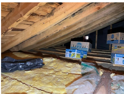
Svertesopp og misfarging
