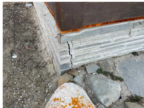
Sprekkdannelser i hjørner.
