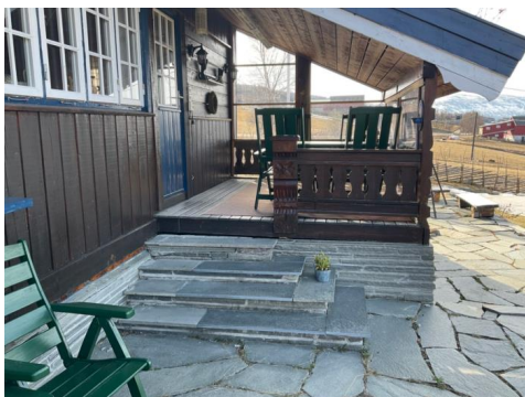
Lavt rekkverk på verandaen.
