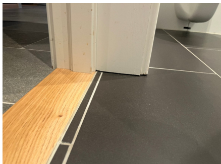
Overgang terskel på bad i første etasje.
