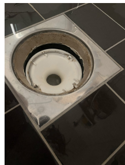
Sluket på baderommet i første etasje.
