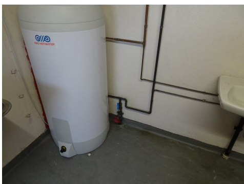
200 ltr står i vaskerommet i kjeller
