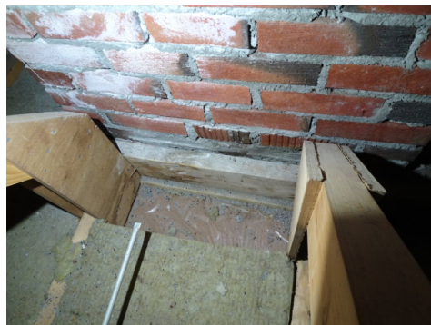
Mangler litt isolasjon ved pipe
