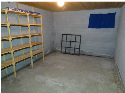
Overflater viser saltutslag og mørkere soppfelter
