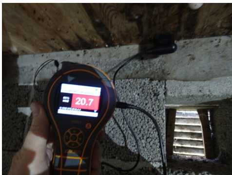
Noe høy trefukt 20,7%
