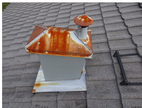
Gamle luftehatter med rust
