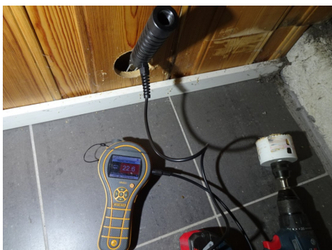
22,6 % trefukt registrert i utforet vegg
