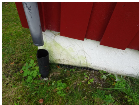
mottaksrør er tett
