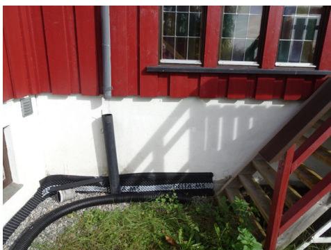
Om trappen fjernes (ifbm ny trapp) må en sjekke ytterligere fuksikring av mur
