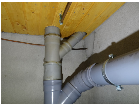
kobberrør med plastkapsling sees med noe irring
