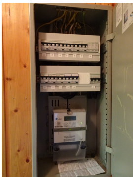
Sikringsskap i vindfang 1 etg. automatsikringer
