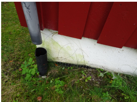
Knottplast mangler klemlist og forsvinner under tettenget
