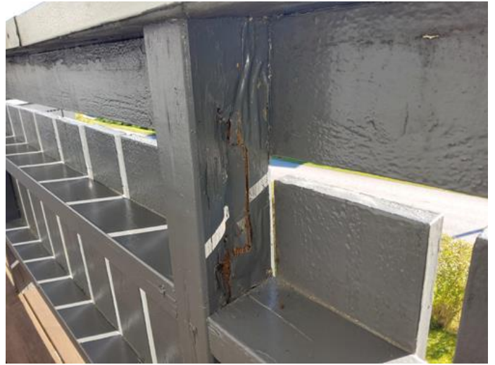
Terrasser/intrukket balkong over innvendige rom - [Eksempel på råteskader- verandarekkverk]
