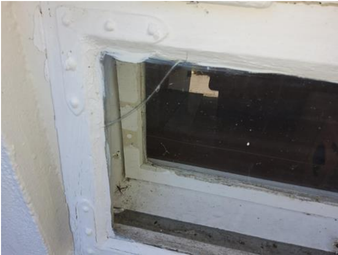
Vinduer - [Sprukket glass kjellervindu]
