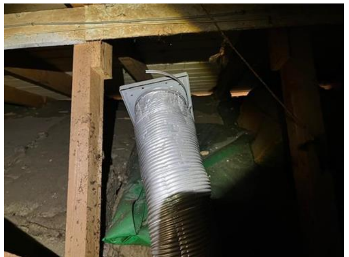
Kommentar - [Avtrekk fra kjøkken]
