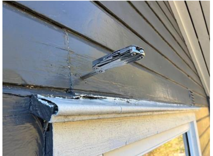
Beskrivelse - [Råteskade på kledning]
