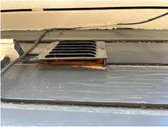
Yttervegger inkl. fasader og konstruksjon - [Løs rist til ventil]
