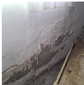
Helhetsvurdering - Eksempel på slitasjer og fuktskader
