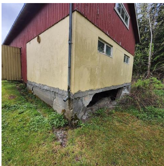
Helhetsvurdering - Eksempel på skader, utrast grunnmur og tydelige sprekker i ovenliggende konstruksjoner
