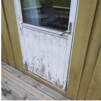
Ytterdører og omramming - Eksempel på slitasjer og skader på balkongdør
