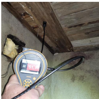
Helhetsvurdering - Eksempel på fuktmåling i kjellerrom mot øst
