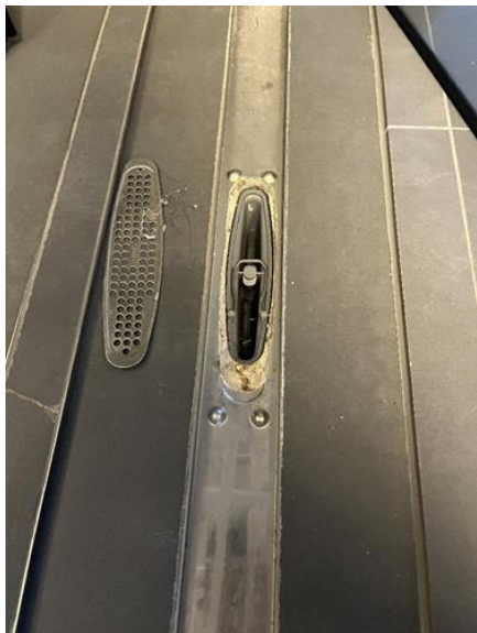
Våtrom - [Sluk i dusjsonen på bad.]
