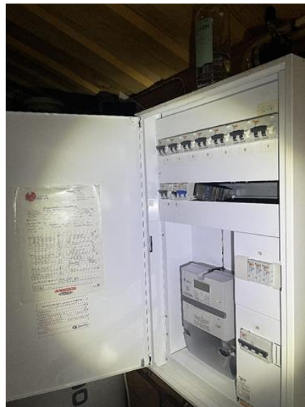
Elektrisk anlegg - [El-skap ]
