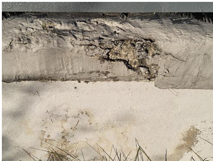
Utvendig - [Slitasje på gammel terrasse]
