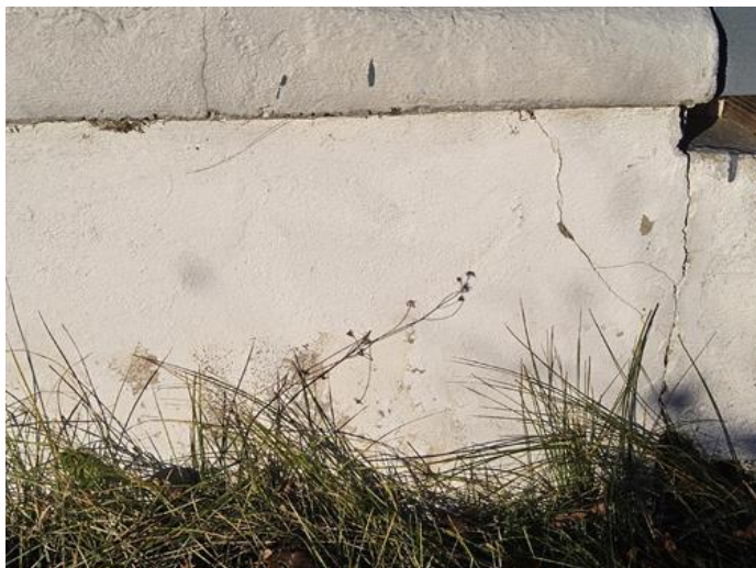
Utvendig - [Riss sprekker i mur gammel terrasse]
