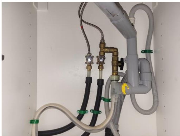
Kjøkken - [Røropplegg i kjøkkenbenk]
