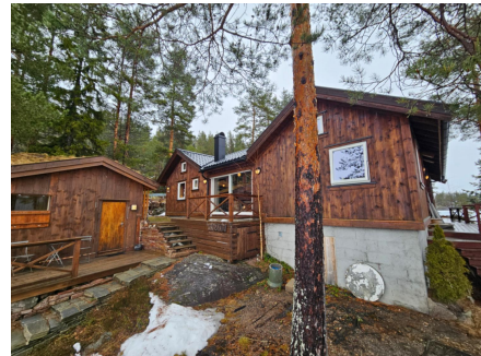
Trappen mangler rekkverk
