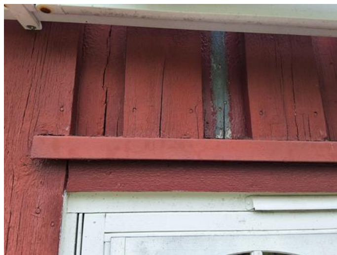
Yttervegger inkl. fasader og konstruksjon - [Oppsprekk kledning]
