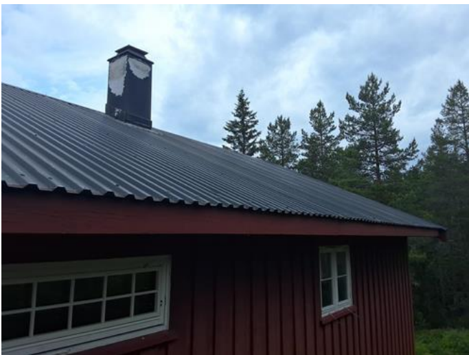
Utvendig - [Yttertak, slitasje på pipebeslag]
