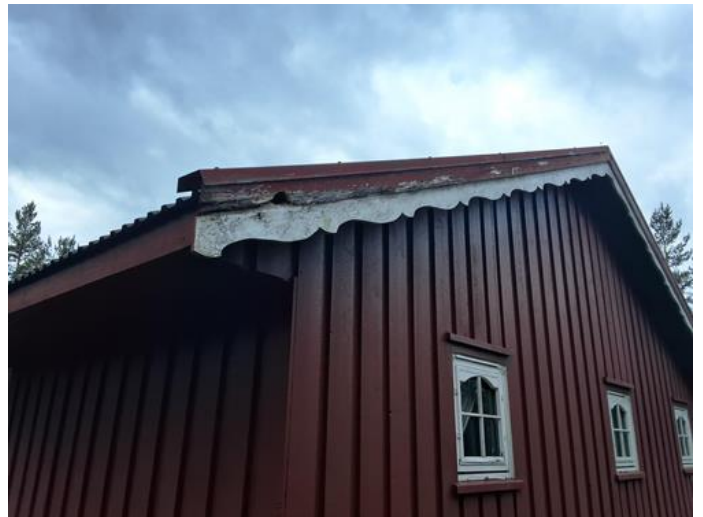
Utvendig - [Yttertak, slitasje på vindskier]
