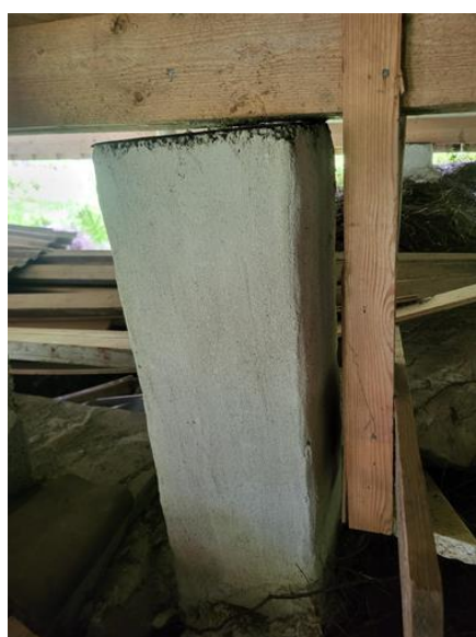
Utvendig - [Løst fundament ]
