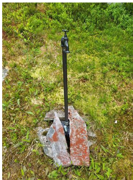
Utvendig - [Vannpost ved borehullet]
