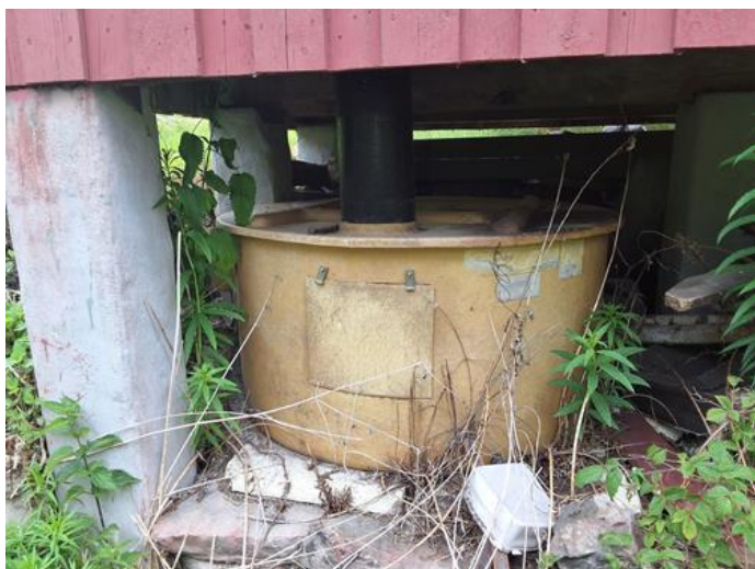
Utvendig - [Glassfobertank til snurredass]
