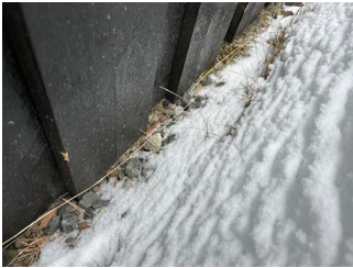
Ytterkledning (fasademateriale, vannbord, utvendig listverk, o.l.) - Kledning avsluttet nær/på bakke
