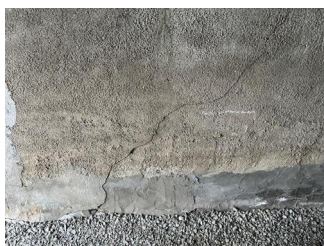
Grunnmur og fundament - Eksempel på sprekkdannelser i mur
