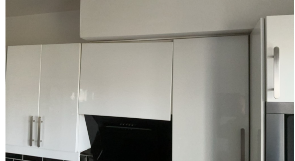
skjevheter i dekkplate over ventilator
