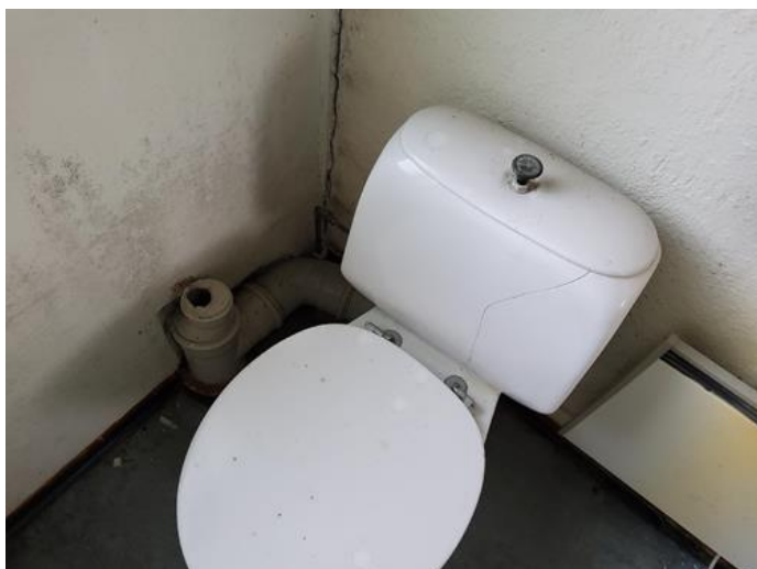
Toalettrom (Ikke våtrom) - [Eksempel på skader]
