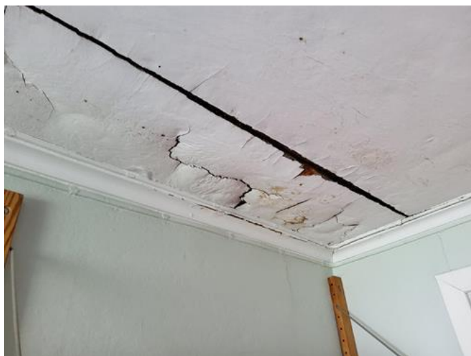
Helhetsvurdering - [Eksempel på skader i himling 2.etasje]
