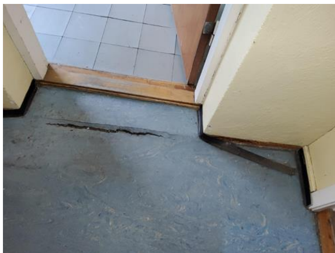
Beskrivelse - [Eksempel på skader]
