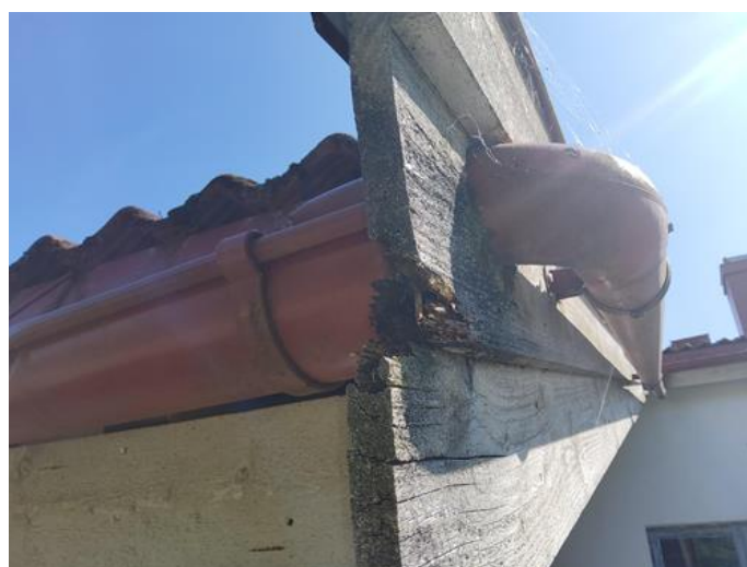
Beskrivelse - [Råteskader på vindskier]
