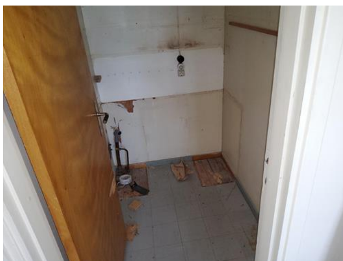
Helhetsvurdering - [Eksempel på skader/slitasje]
