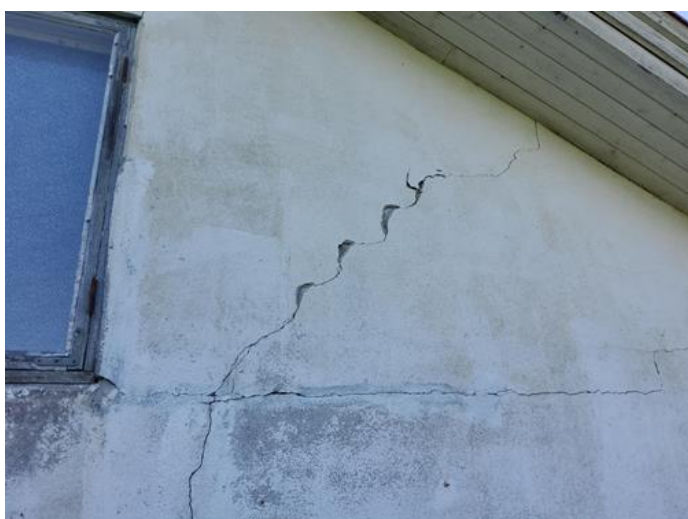
Beskrivelse - [Eksempel på riss/sprekker i yttervegg]
