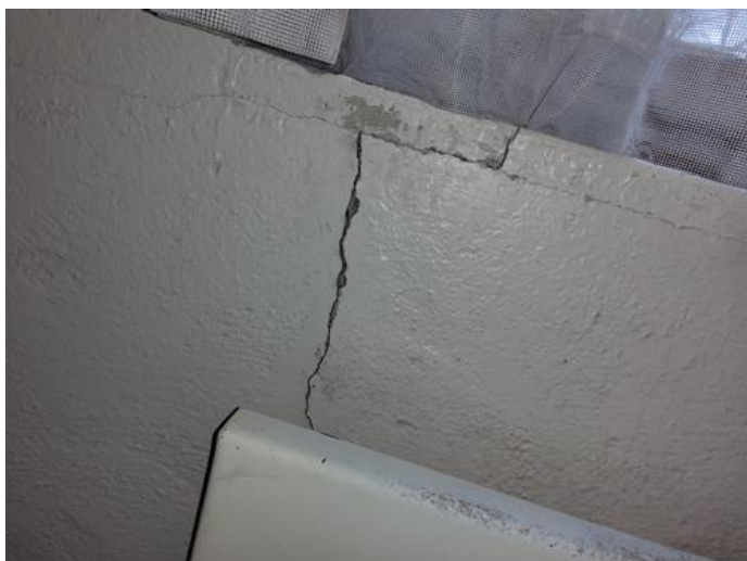
Helhetsvurdering - [Sprekkdannelser på yttervegg]
