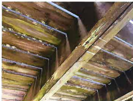
Lett råte- og algeangrep
