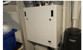
Mekaniske ventilasjonsanlegg (utover det som nevnes under andre sjekkpunkter) - Ventilasjonsaggregat.
