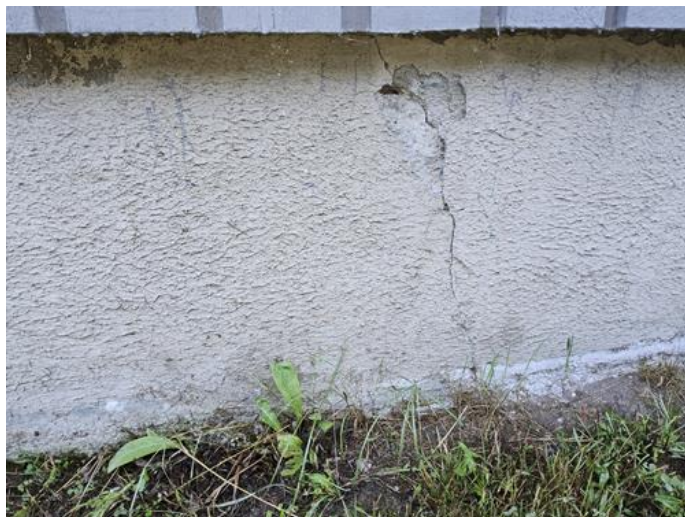
Grunnmur, fundamenter - [Pussavskaling og riss/spekk i grunnmur]
