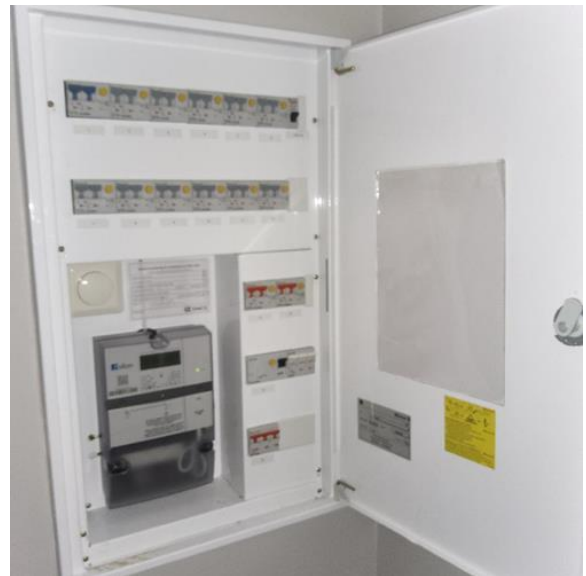
Elektrisk anlegg - [Sikringsskap plassert på soverom]
