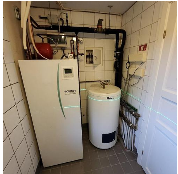
Innvendig - [Teknisk anlegg plassert i vaskerom]
