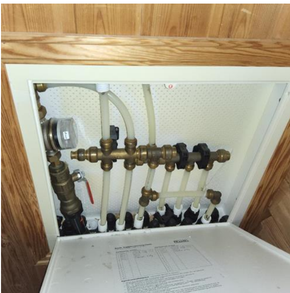
Innvendig - [Fordelerskap for rør-i-rør system plassert på bad 1.etasje ]
