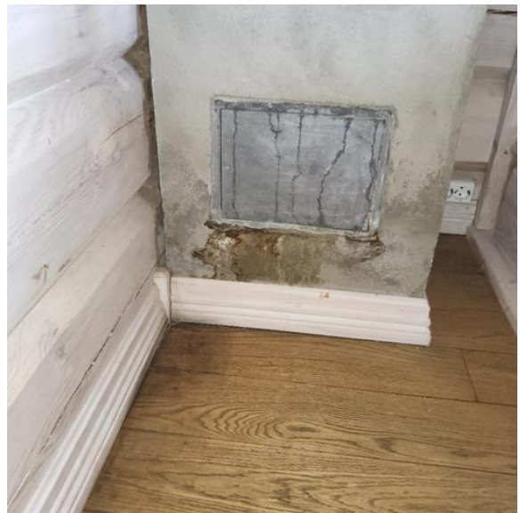
Innvendig - [Eksempel på fuktmerker på pipe]
