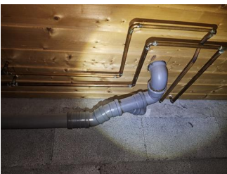
Avløprør (utover det som nevnes under andre sjekkpunkter) - Vann og avløpsrør fra byggeår
