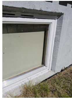
Vinduer og omramming - Kjellervinduer er nært terreng.
