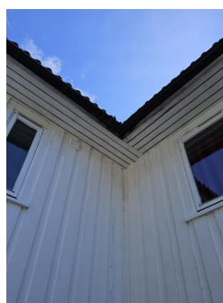
Vannbord, vindskier, gesimskasser og lignende - Tegn på råte i kassebord under kilrenne.
