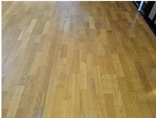
Overflate gulv - Slitasje gulv
