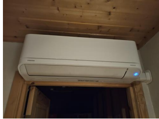
Varmepumper - Varmepumpe i underetasje
