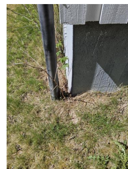
Bortledning av takvann - Tegn på fuktmerker i kjeller inne, kan være tette rør fra takvann
