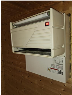
Tekniske anlegg (kjøleaggregat, badstueovn med mer) - -
