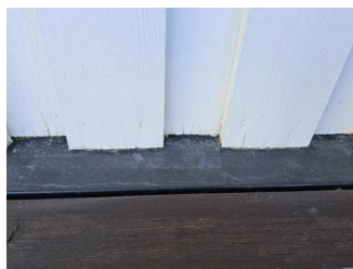
Ytterkledning (fasademateriale, vannbord, utvendig listverk, o.l.) - Oppsprekk/slitasje, ikke tilstrekkelig klaring mot beslag.
