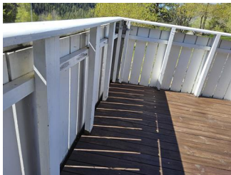
Tilstand på rekkverk og overflatematerialer - Slitasje på rekkverk
