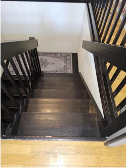
Tilstand - Tegn på noe slitasje
