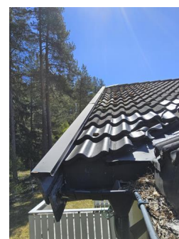
Tekking (med tilhørende beslag) - Knekte takstein ved kilrenne.
