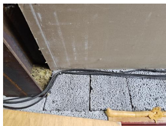
Annet - Manglende gass/eksos tetting til øvrige rom
