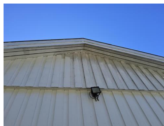
Ytterkledning (fasademateriale, vannbord, utvendig listverk, o.l.) - Svertesopp/slitasje av kledning observeres.
