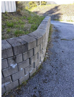
Tilstand - Tegn på at støttemur av betongblokker heller utover.
