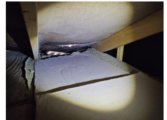
Synlige overflater (taktro, vegger, gulv, o.l) - Fuktmerker/skader på undertak
