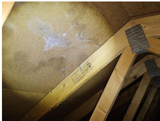
Synlige overflater (taktro, vegger, gulv, o.l) - Muggskjolder
