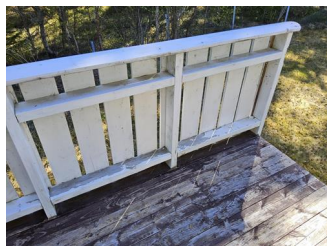
Tilstand på rekkverk og overflatematerialer - Slitasje på terrassebord og rekkverk
