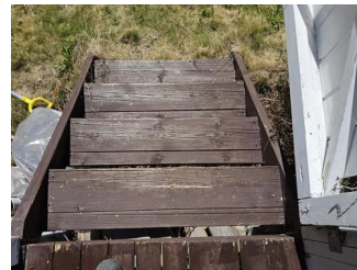
Tilstand på rekkverk og overflatematerialer - Slitasje trapp
