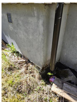
Bortledning av takvann - Stedvis ikke ledet vekk fra grunnmur.
