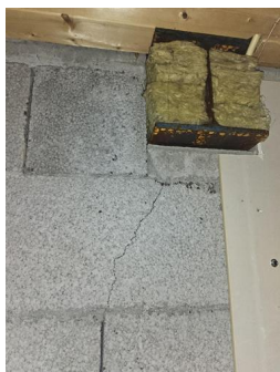
Grunnmur og fundament - Sprekk i lettklinkerblokker ved jerndrager i bod/garasje
