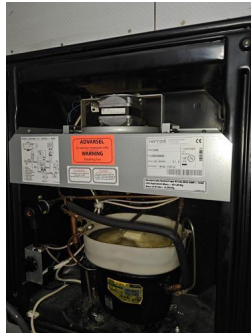
Tekniske anlegg (kjøleaggregat, badstueovn med mer) - .
