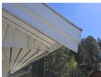
Vannbord, vindskier, gesimskasser og lignende - Slitasje vindskier
