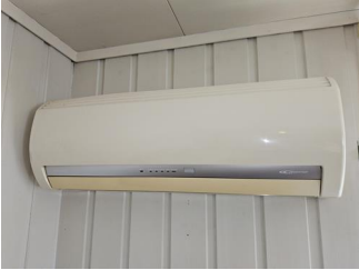
Varmepumper - Varmepumpe i stue
