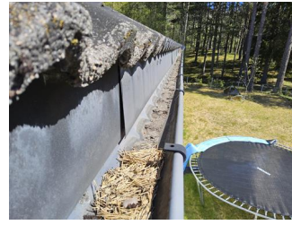
Takrenner og utvendige nedløp - Slitasje på takrenner
