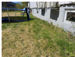
Terrengfall fra grunnmur - Lite fall vekk fra grunnmur
