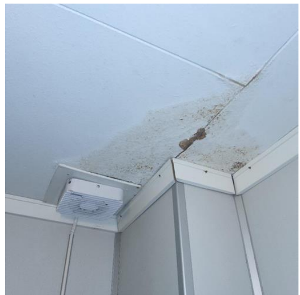
Våtrom - [Eksempel på fuktskader i himling på bad 1.etasje ]
