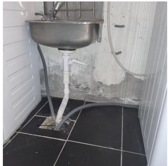
Innvendig - [Eksempel på slitasjer vaskerom ]
