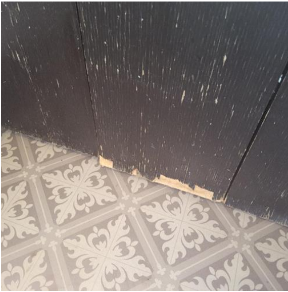
Våtrom - [Eksempel på slitasjer og fuktskader innredning bad 1.etasje ]
