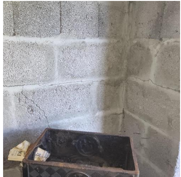
Utvendig - [Eksempel på sprekker i grunnmur]
