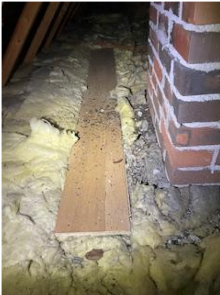
Loft - uinnredet / råloft - [Eksempel på spor etter skadedyr på loft]
