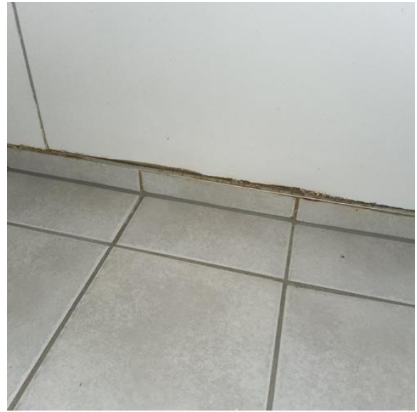
Våtrom - [Eksempel på fuktskader bad underetasje ]
