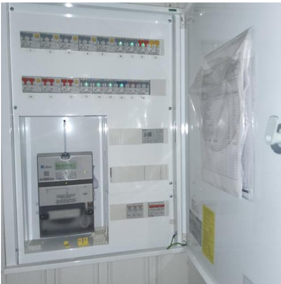
Elektrisk anlegg - [Sikringsskap og kursoversikt plassert gang underetasje ]
