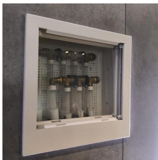
Fordelerskap og fordelerstammer
