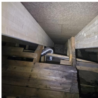
Kondensisolering av rør og ventilasjonskanaler - Uisolert ventilasjon fra kjøkken avsluttet på loft
