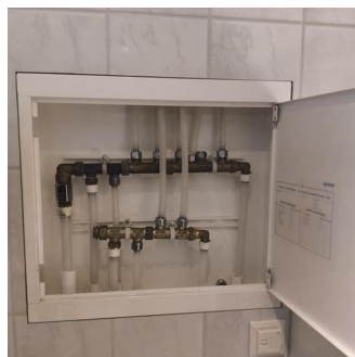
Fordelerskap og fordelerstammer
