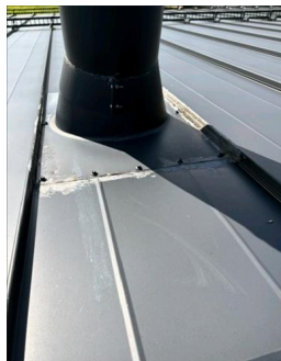
Takgjennomføringer (takhatte o.l.) - Eksempel på pipebeslag limt over og ikke ført under takplater
