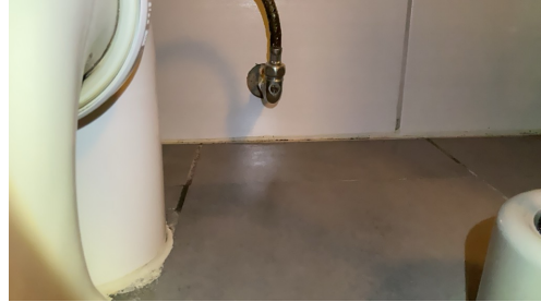
Utilfredstillende tetting ved rørgjennomganger
