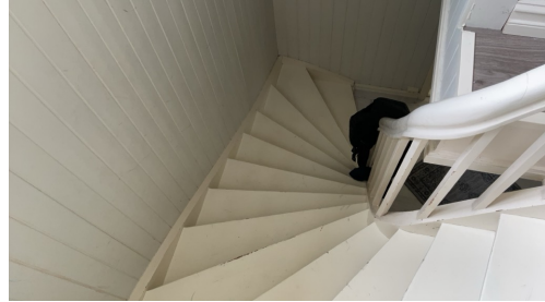
Det mangler håndløper på vegg i trappeløpet.
