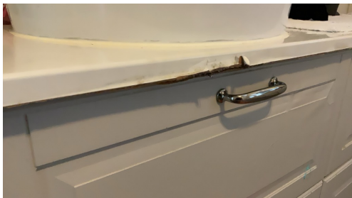
Innredning har skader.
