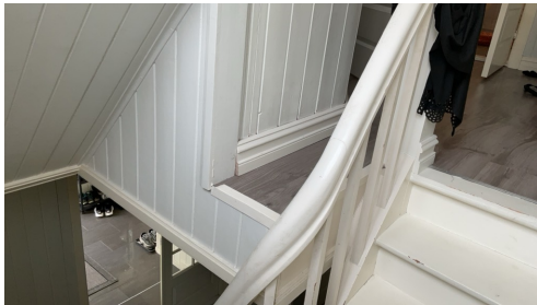
Det mangler rekkverk i topp av trapp.
