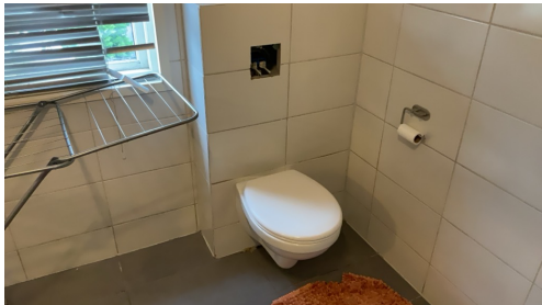
Det mangler løsning for å synliggjøre lekkasje fra innebygget susterne.
