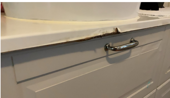
Innredning har skader.
