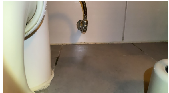
Utilfredstillende tetting ved rørgjennomganger
