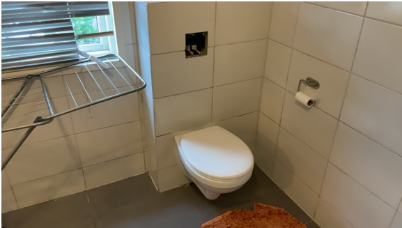
Det mangler løsning for å synliggjøre lekkasje fra innebygget sisterner.
