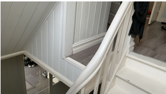
Det mangler rekkverk i topp av trapp.
