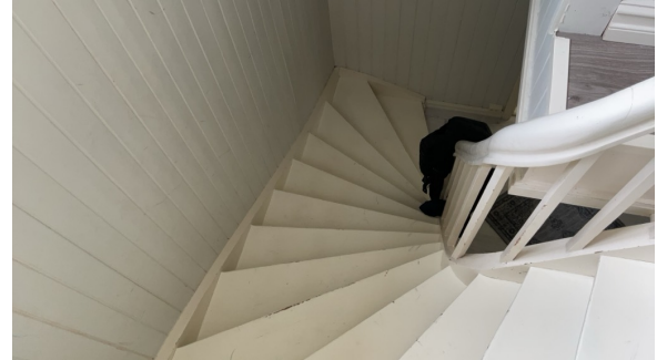
Det mangler håndløper på vegg i trappeløpet.
