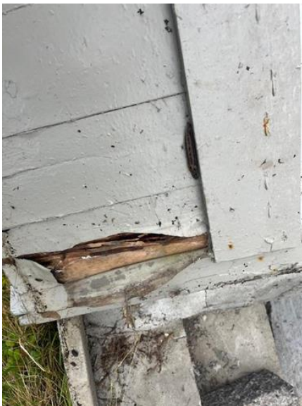
Helhetsvurdering - [Råteskader på kjellerlem]
