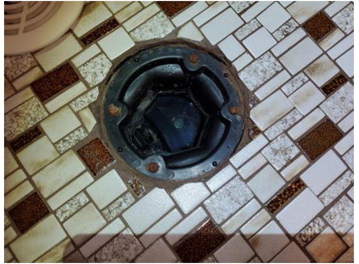
Kommentar - [Sluk bad 1.etasje]
