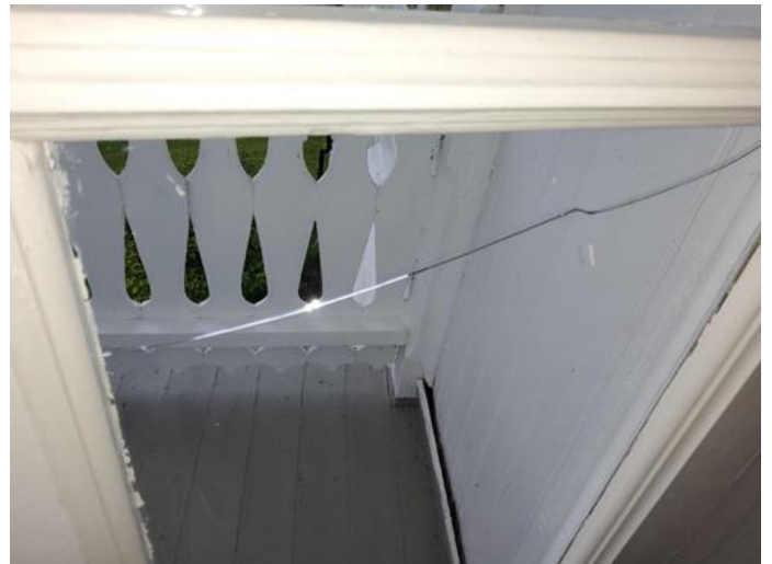
Dører og vinduer - [Sprukket glass balkongdør]
