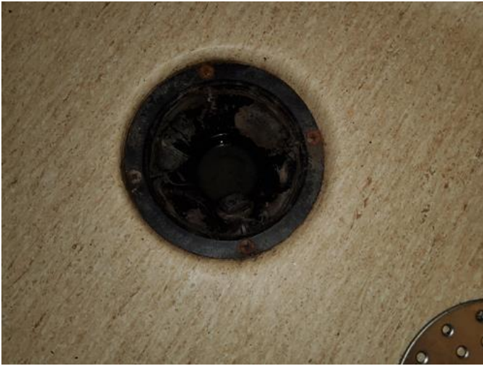
Våtrom - [Sluk bad 2.etasje]
