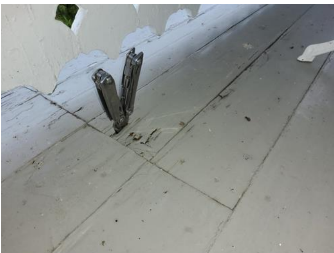
Beskrivelse - [Eksempel på råteskader i gulvbord på balkong]
