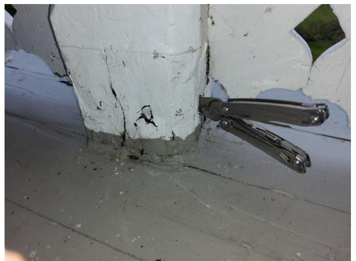
Beskrivelse - [Eksempel på råteskader i søyle på balkong]
